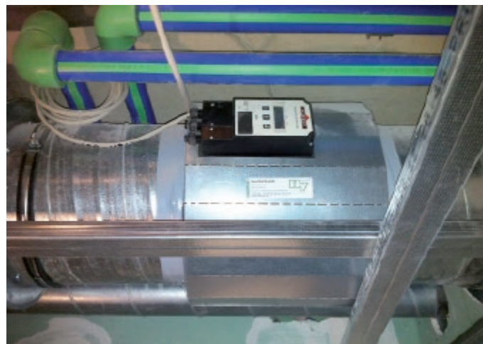
Die elektronischen Volumenstromregler (hier mit Dämmschale) konnten aufgrund der kompakten Bauform auch bei engen Platzverhältnissen problemlos installiert werden.
