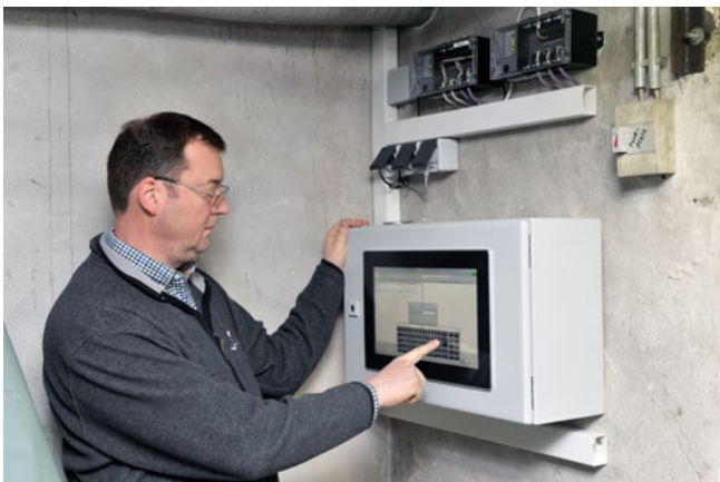
Die automatische Funktionsprüfung der neuen Brandschutzklappen übernimmt ein eigenständiges, komplett vorkonfiguriertes Kommunikationssystem.
