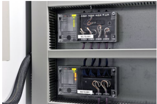
Neben dem I/O-Modul (unten im Bild) integrierten die Projektverantwortlichen auch den Subnetzcontroller in einen Schaltschrank, der die vier nachgeordneten Netze verwaltet.
